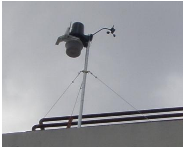
Μετεωρολογικός Σταθμός « ΠΑΤΗΣΙΑ». Εξωτερική μονάδα
